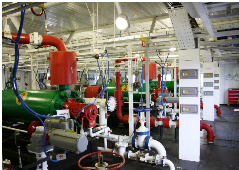
Рисунок 1 – Внутренний вид -машинный зал Кустовой насосной станции
